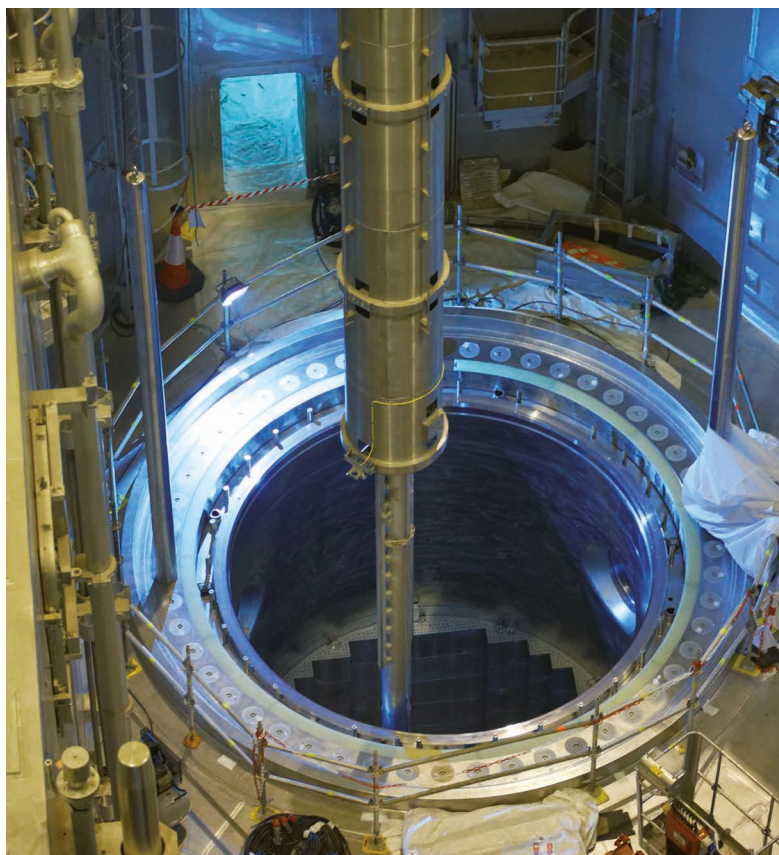
EPR Flamanville : l'IRSN participe au suivi des essais de démarrage (ci-dessus, machine de chargement du combustible en phase de réglage de positionnement dans la cuve du réacteur).
