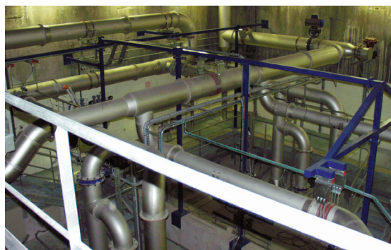
Vue partielle du réseau de ventilation
