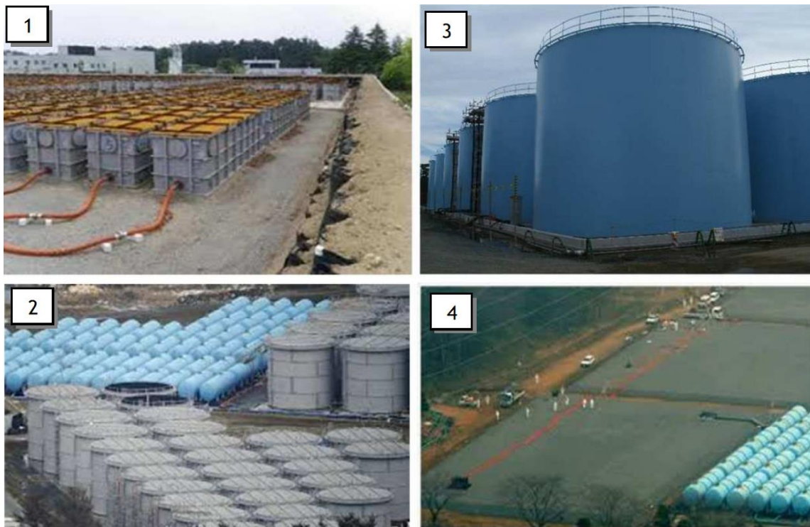
Source TEPCO - 1/réservoirs cubiques soudés - 2/réservoirs verticaux à assemblages par brides boulonnées et réservoirs horizontaux soudés - 3/réservoirs verticaux soudés - 4/réservoirs enterrés
