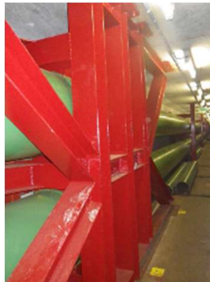
AGRESSION SEISME Renfort supportage tuyauteries
