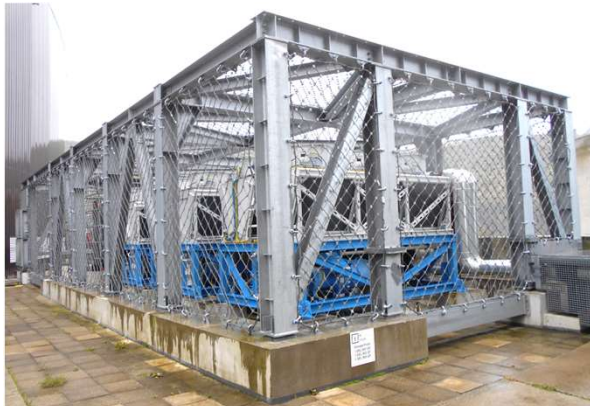
AGRESSION GRAND CHAUD Groupes froids de réfrigération locaux électriques (protégés projectiles grand vents)
