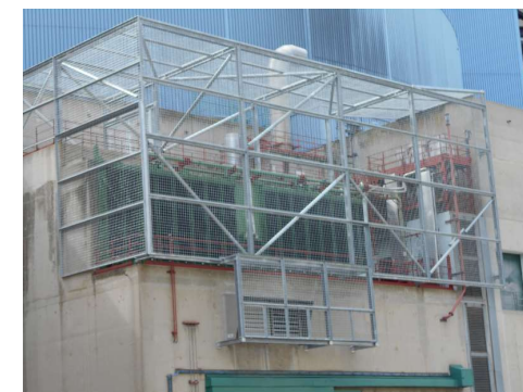
Protections contre les projectiles générés par les vents extrêmes des aéroréfrigérants des diesels
