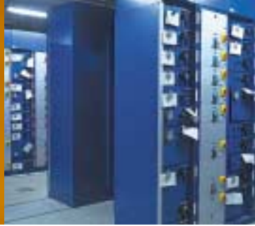
Armoires électriques consignées dans le bâtiment électrique de la tranche 2 de la centrale de Civaux (Vienne).
