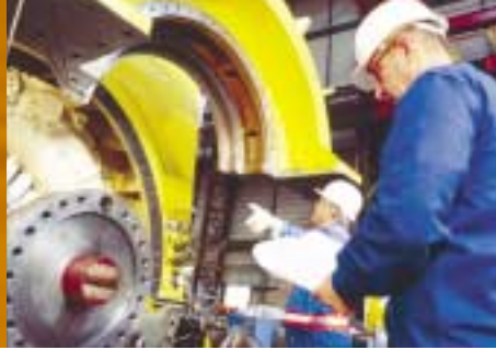
Opération de maintenance sur une turbine à la centrale de Dampierre-en-Burly (Loiret).
