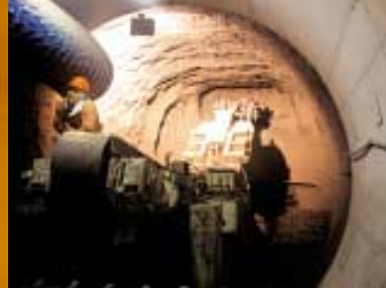
Creusement de la galerie principale en 2003, dans l'installation expérimentale de Tournemire (Aveyron).
