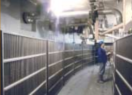
Puisard RIS, centrale nucléaire de Civaux (Vienne).
