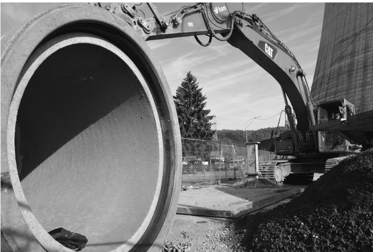
Figure 37.3. Vue montrant les travaux de déviation du pertuis communal en amont du site de Tihange. Centrale nucléaire de Tihange.
