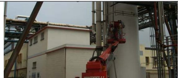
Débouchage : Les deux intervenants ouvrent les tuyauteries. Les opérateurs en salle de commande envoient de l'azote dans la canalisation afin de déloger l'agrégat de produit
