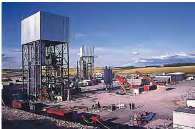
Têtes de puits du laboratoire de recherche souterrain de Bure (Meuse/Haute-Marne). Les galeries seront situées à 500 m sous terre, dans une couche argileuse.
