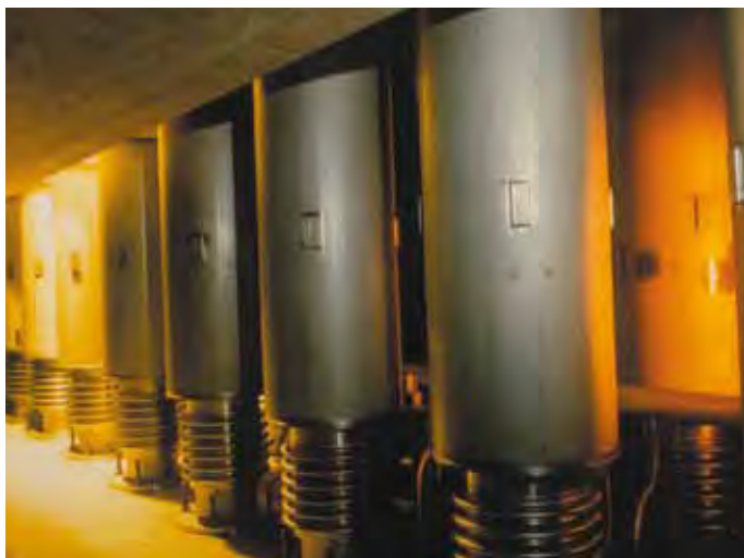
Entreposage de déchets vitrifiés. Vue en partie basse de puits (La Hague).
