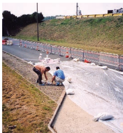
Après l'accident, la zone contaminée a été bâchée sur environ 100 m 2 .
