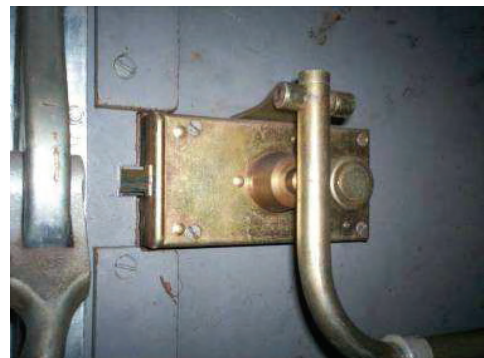
Serrure de la porte métallique d'accès à la cellule d'ionisation
