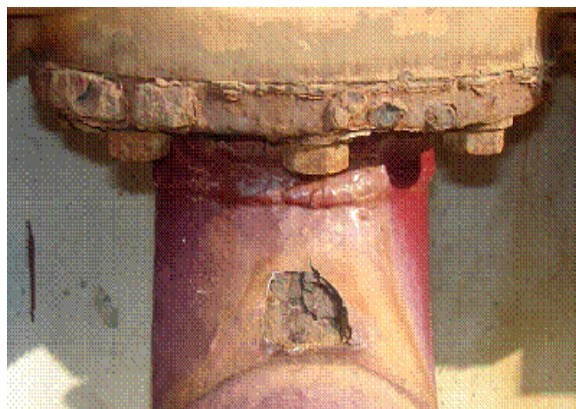
Photo 1 : Exemple d'une corrosion externe d'une tuyauterie de refroidissement. A terme, ce type de corrosion peut conduire au percement de la tuyauterie
