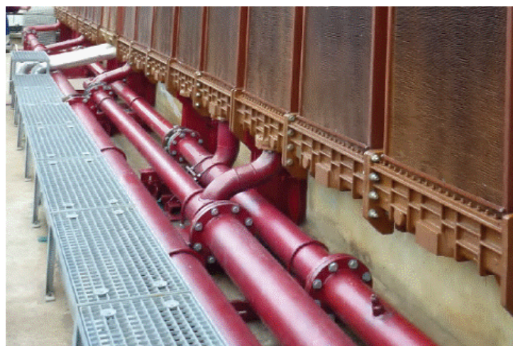
Photo 4 : l'installation remise en conformité à la centrale de Flamanville (aéroréfrigérant d'un groupe électrogène de la tranche 2)
