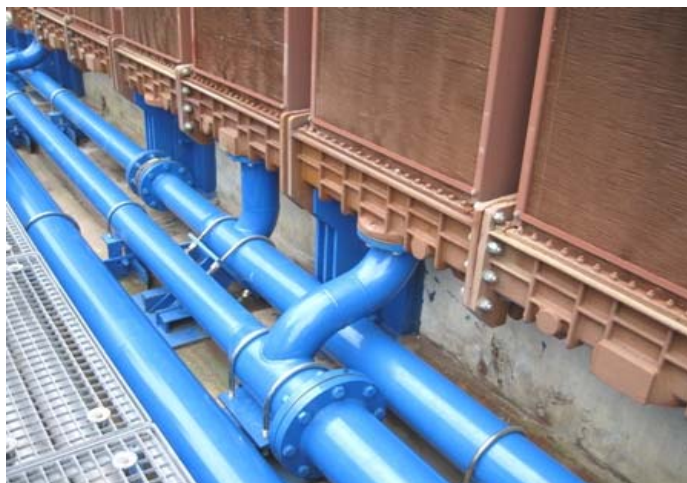
Photo 3 : l'installation remise en conformité à la centrale de Flamanville (aéroréfrigérant d'un groupe électrogène de la tranche 1)
