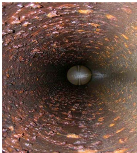
Corrosion sur les parois internes des tuyauteries d'eau brute
