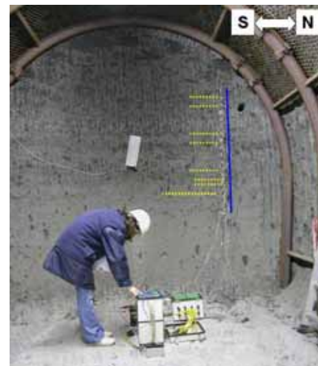
Figure II.85. Etude locale des hétérogénéités : fractures de désaturation (ouverture ~ 1 mm) au fond de la galerie Ouest-08 (bleu : profil électrique, jaune : présence des hétérogénéités ciblées). Sur l'axe du front de la galerie, on remarque l'extensomètre qui n'est pas en fonctionnement.
