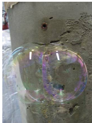
Figure 60 : Mise en évidence de la fuite d'air injecté, par la fissure.
