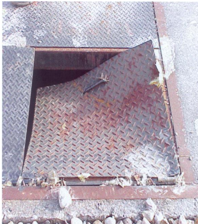
Figure 60 : Point d'entrée de l'eau dans les galeries techniques (IRSN, 2000)
