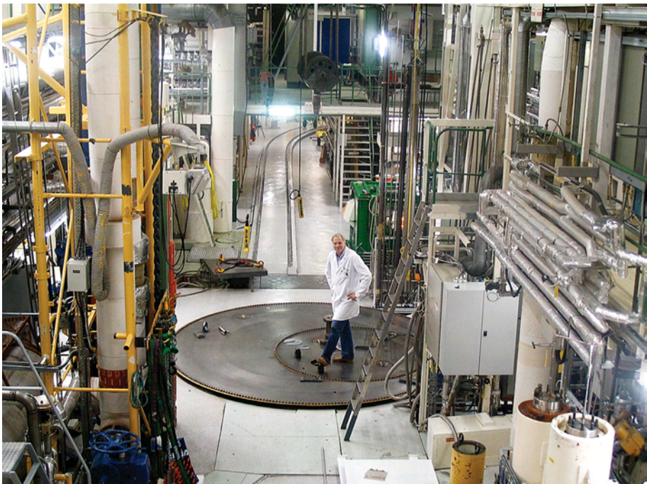
Figure 11.2. Vue du hall du réacteur HALDEN. © IFE (Institutt for energiteknikk).
