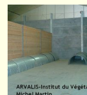
Stockage ventilé en vrac
