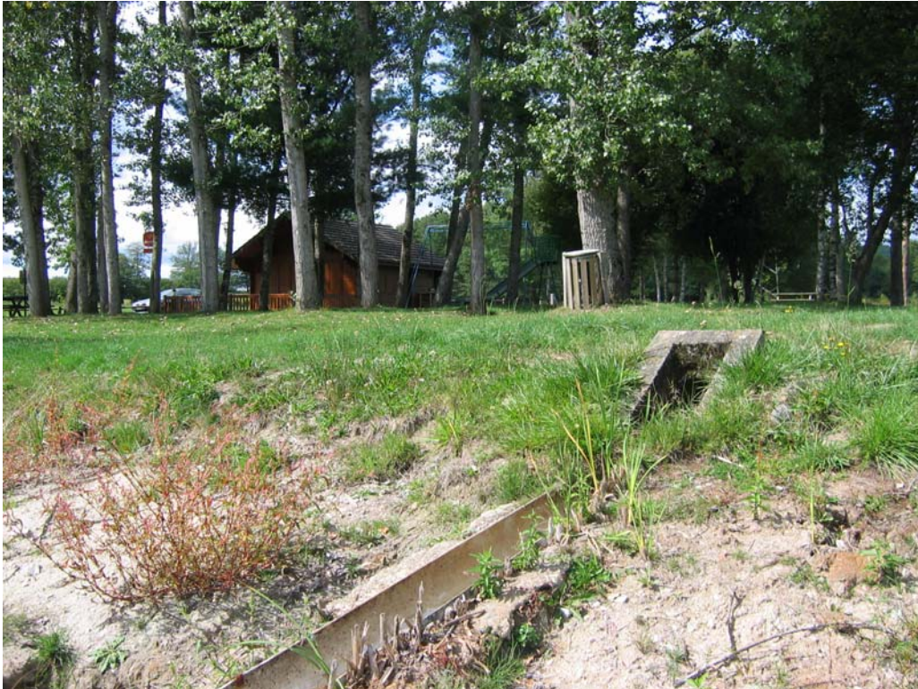
Photo 9 : Collecte des arrivées d'eau de la parcelle Gérémy et du stand de tir devant la buvette du plan d'eau
