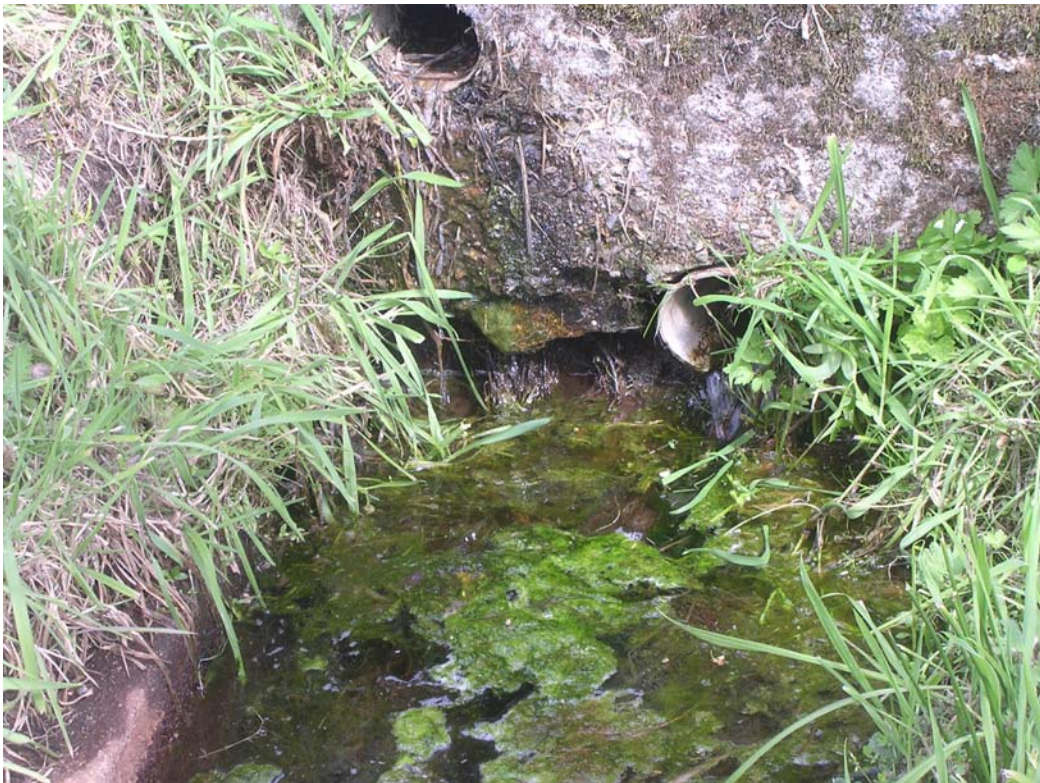
Photo 12 : Reprise du trop plein du puits G r my et autre drainage de la parcelle
