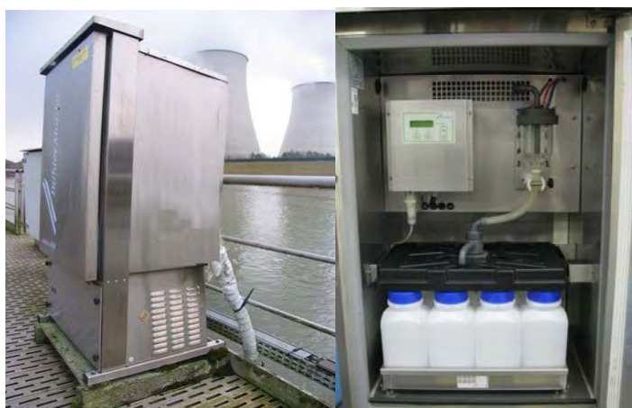
Figure 30 : Hydrocollecteur en fonctionnement (gauche) et détail du dispositif de prélèvement (droite)
