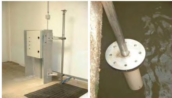
Figure 105 : Photos d'une station Téléhydro (vue générale et détaillée de la sonde)
