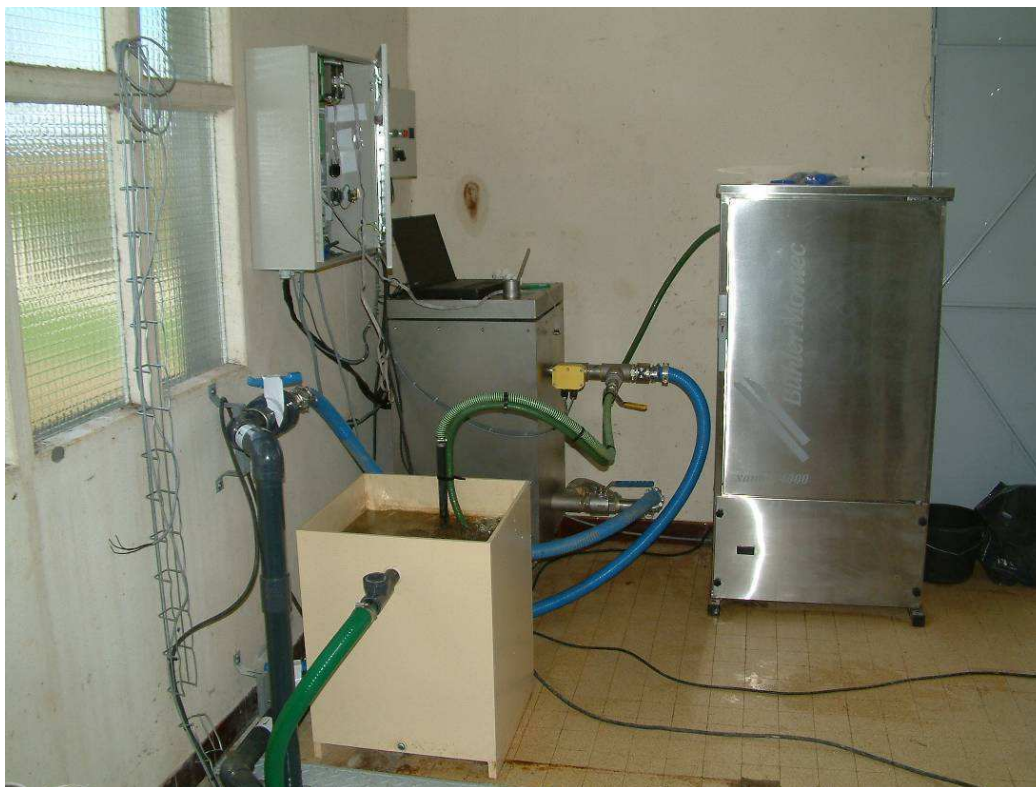
Figure 77 : photo d'une station hydrotéléray
