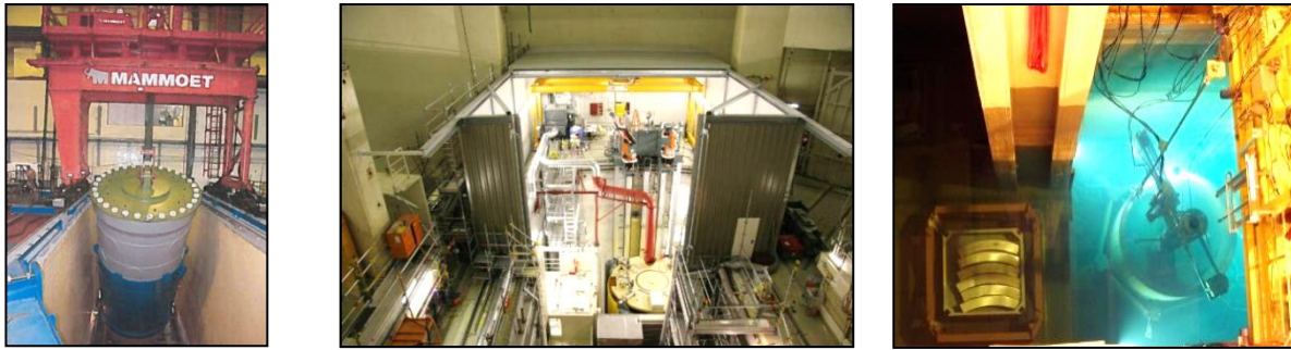
Figure 6.14 - Cuve extraite monobloc d'une des unités de Greifswald (Allemagne). Poste de découpe à sec de la cuve du réacteur Stade (Allemagne). Découpe sous eau de la cuve du réacteur José Cabrera (Espagne)
