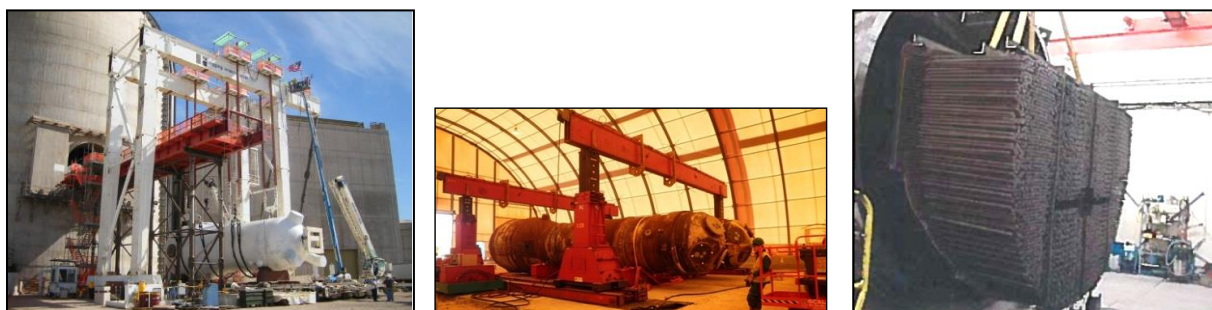
Figure 6.13 - GV évacué monobloc d'une des unités de Zion (USA). GV transporté monobloc depuis le CNPE de Chozy et stocké en l'état dans le Cires de Morvilliers (France). GV découpé à la centrale de Greifswald (Allemagne)
