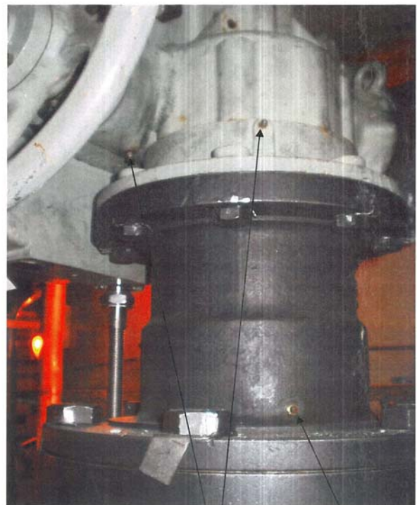
Proximité des graisseurs des servomoteurs et boîte à butée source d'erre
