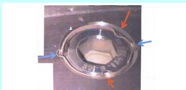
Verrouillage antirotation de la coupelle (exemple de la vis n°2, Civaux 1) Flèches bleues : points de sertissage dans le lamage Flèches rouges : points de sertissage dans la tête de vis
