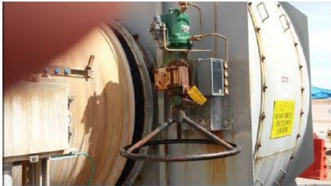
Figure 16 : vanne manuelle d'ouverture des registres, à l'extérieur de l'installation Elle permet d'ouvrir les registres des petits ventilateurs et leur démarrage (source DOE [58])
