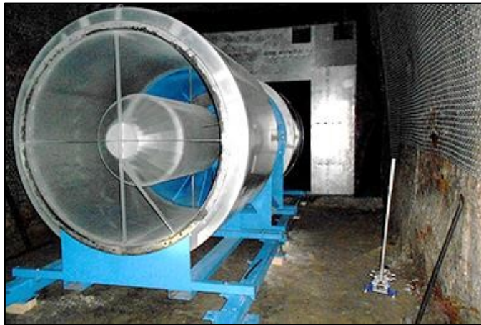
Figure 47 : Le ventilateur du système de ventilation supplémentaire (source DOE [62])
