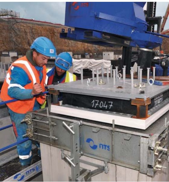
493 patins parasismiques supporteront le plancher du futur tokamak ITER.
