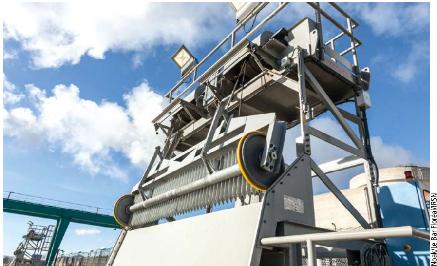
À Cruas (Ardèche), le dégrilleur – peigne mobile automatique – récupère les débris charriés par l'eau avant son entrée dans le tambour filtrant.
