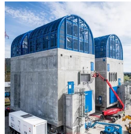
Diesel d'ultime secours
