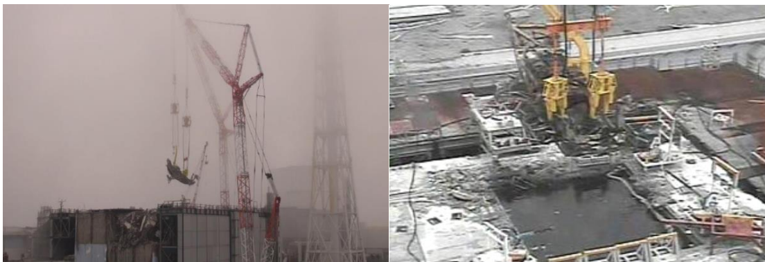
Source TEPCO - Retrait d'un pont de manutention du combustible de la piscine du réacteur 3
