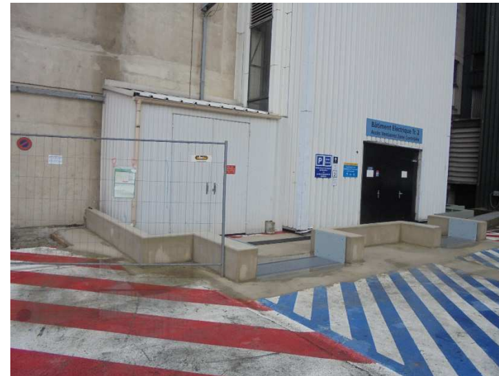
Batardeaux amovibles automatiques (mise en place automatique du fait du poids de l'eau arrivant sur la plateforme)
