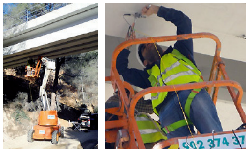
Instrumentation d'un pont avec un capteur à fibre optique (Torres et al. 2016)
