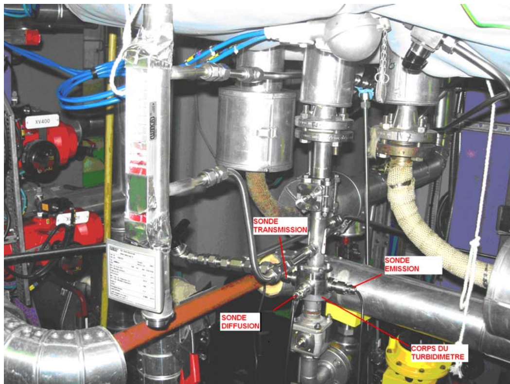
Fig. 3-39 Vue du système de turbidimétrie en ligne en dessous du puisard
