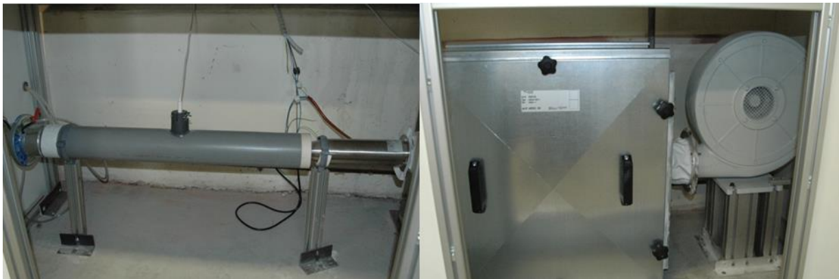
Figure II-31 : Ventilateur, caisson de filtration amont, réchauffeur, capteur de température et diaphragme
