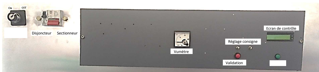
Figure 2.29 : Tableau de commande du système électrique
