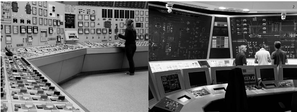
Figure 16.1. À gauche, vue d'une salle de commande conventionnelle (centrale nucléaire de Fessenheim). Médiathèque EDF – Mario Fourmy; à droite vue d'une salle de commande informatisée d'un réacteur du palier N4 (centrale nucléaire de Civaux). Romain Beaumont photographies.
