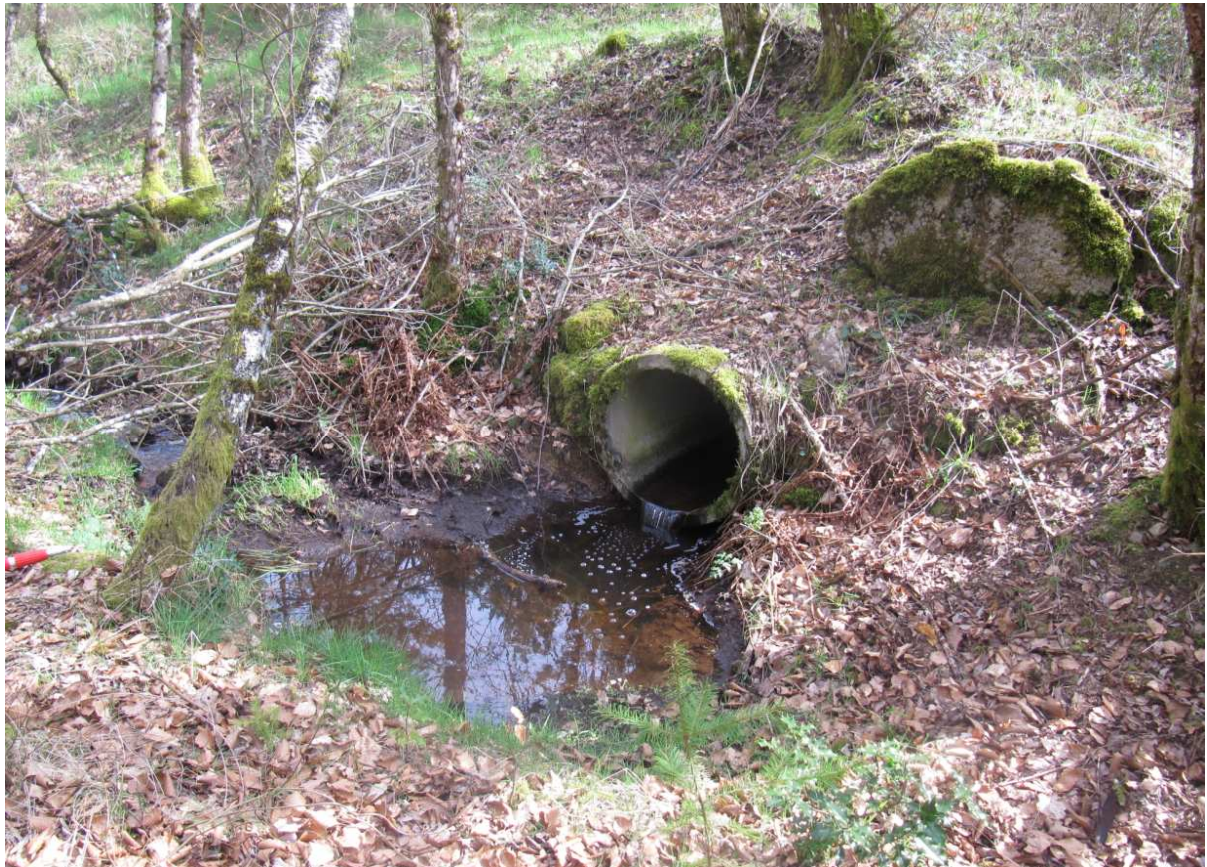
Figure 7 : Canalisation en sortie de verse Nord, drainant le ruisseau Le Pré Bos sous la verse
