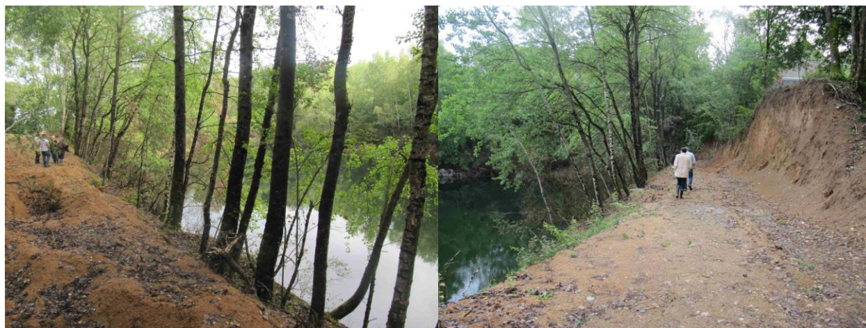
Figure 9 : Bordure Sud de la fosse en eau, en travaux au moment de la visite de l'IRSN.
