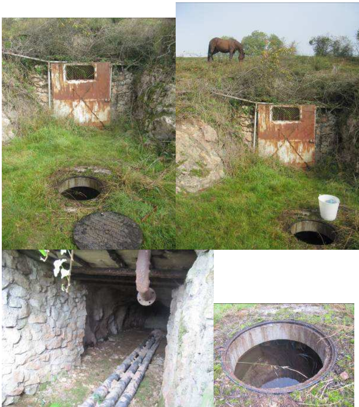
Figure 5 : Site Les Riaux : entrée du TB2, regard sur les canalisations des eaux provenant des TMS, ancien travers-banc et canalisations des eaux (prélèvement IRSN M_RUA_TB2).
