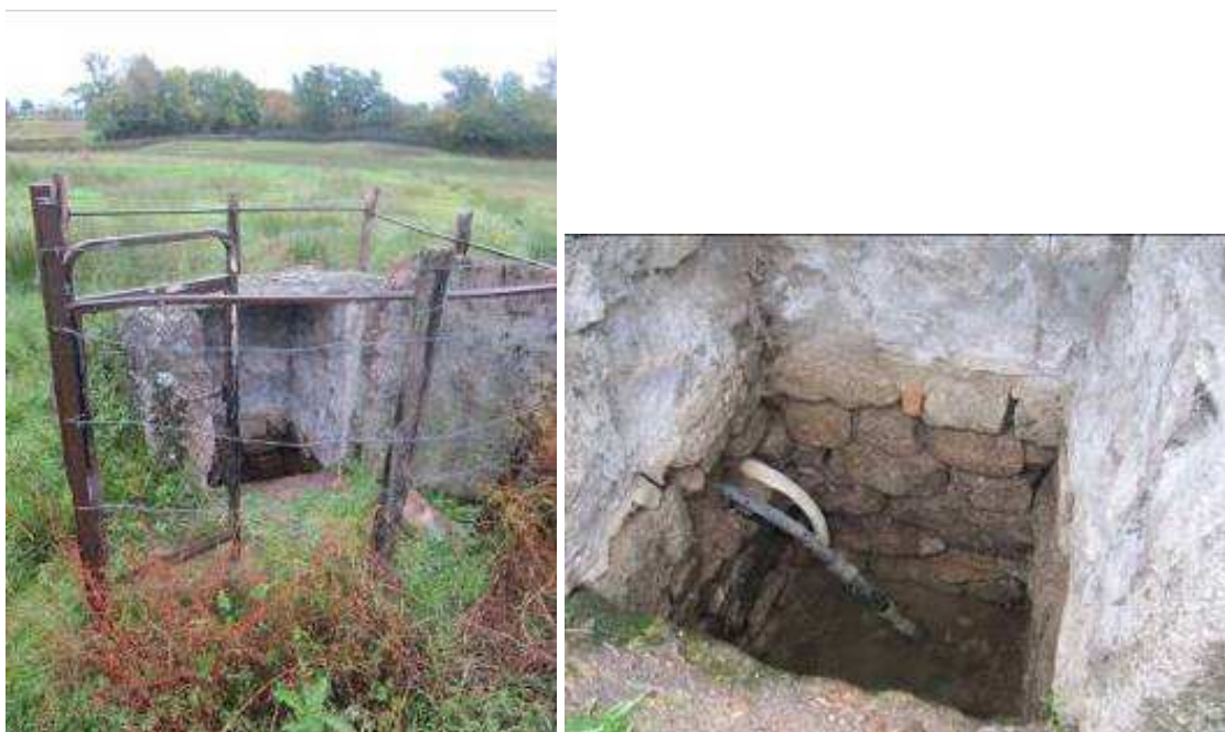
Figure 8 : Source privée de la ferme des Usages située à l'Est du site (prélèvement M_OUD_SCE).
