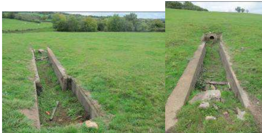
Figure 7 : Site Le Rompey. Goulotte recevant les eaux provenant des TMS en période de hautes eaux (à sec au moment de la visite de l'IRSN).
