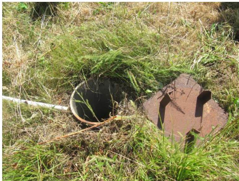
Figure 8 : Piézomètre installé à proximité de l'ancien puits (prélèvement IRSN M_SAP_PIEZ)
