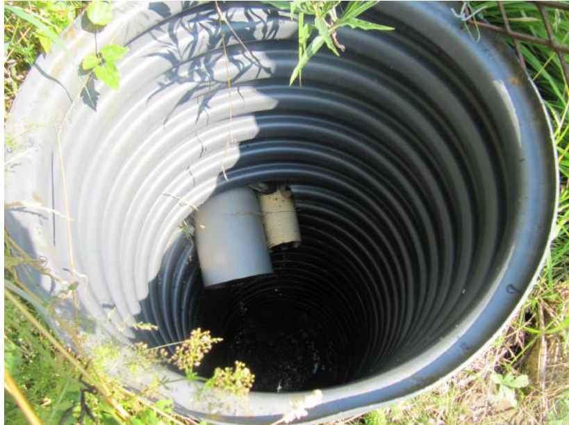
Figure 12 : Regard sur les eaux canalisées à l'aval de la MCO du site Les Bondons où a été réalisé le prélèvement M_BON_MCO.
