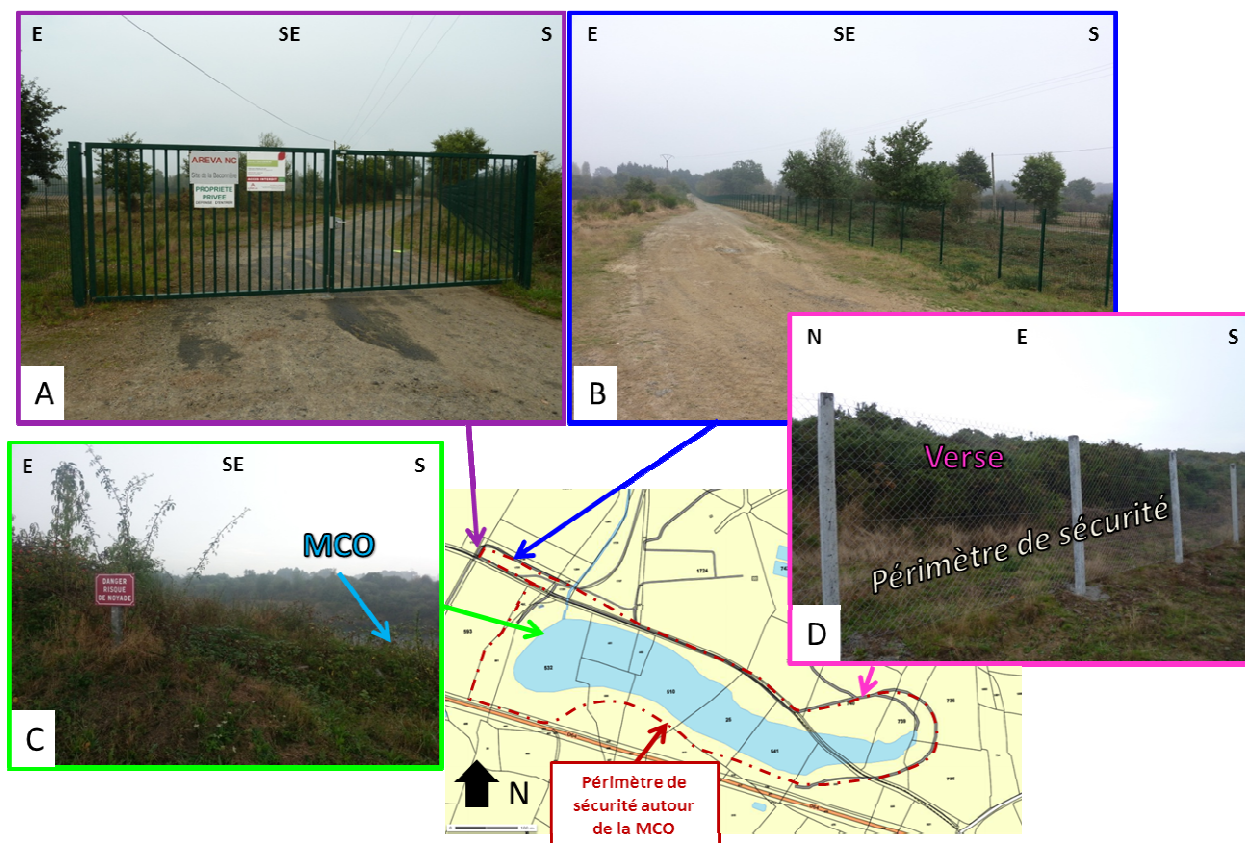
Figure 39 : Photographies des travaux de mise en sécurité de la MCO la Bastille ; A- Portail d'accès au site de la Baconnière, B-Clôture du périmètre de sécurité au Nord du site, C- Panneau signalant un risque de noyade au niveau de la MCO la Bastille, D- Périmètre de sécurité entre la MCO et la verse à stérile (sur fonds Géoportail IGN © [4])
