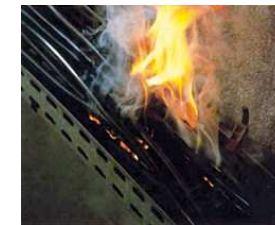
Feu de câbles
