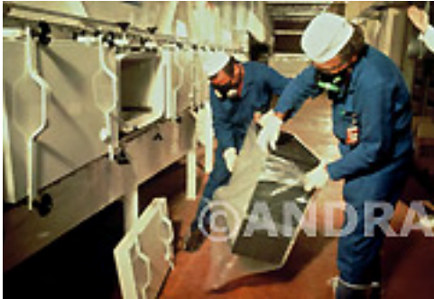
Filtres de ventilation
