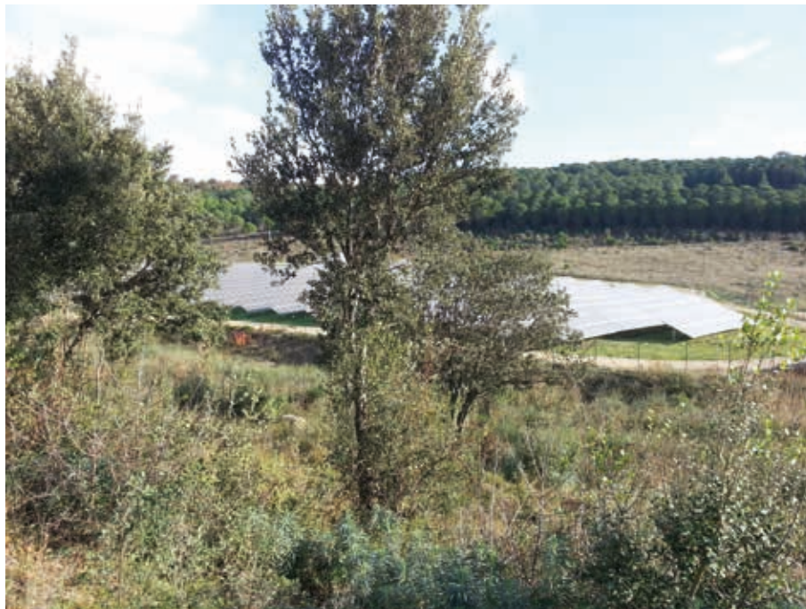
Panneau photovoltaïque sur le site du Bosc
