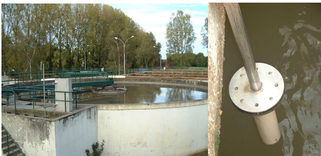
Figure 64 : Photos d'une station Téléhydro (vue générale et détaillée de la sonde)
