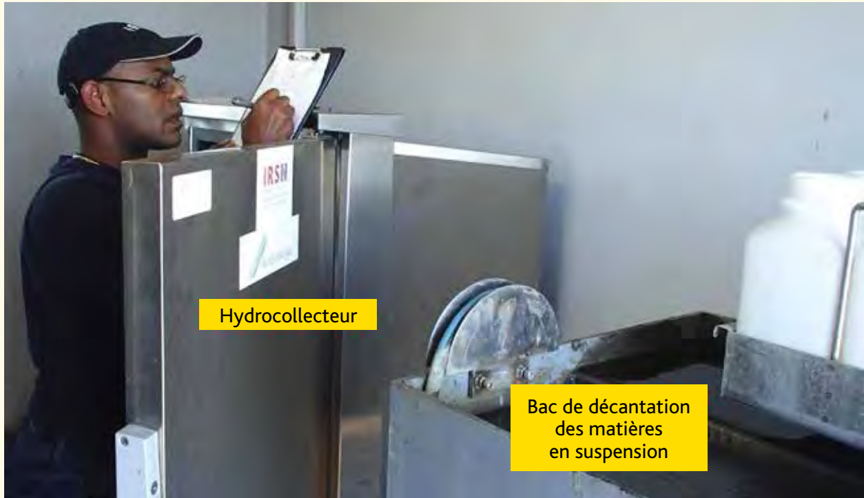
■ Figure II.56 - Hydrocollecteur et bac de décantation des matières en suspension.
