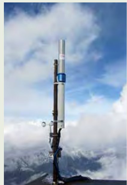
Figure 1.10 - Balise Téléray de nouvelle génération installée à l'Aiguille du midi (massif du Mont blanc, 3 842 mètres d'altitude).
