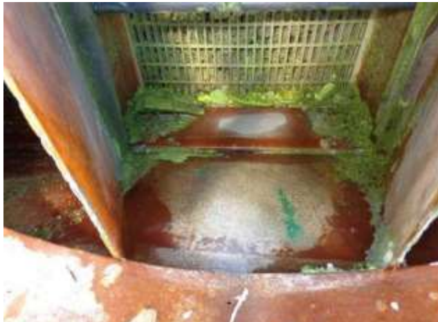
Figure 2.22 - Exemple d'accumulation de matière fissile (couleur jaune-vert) dans un équipement d'un réseau de ventilation d'une installation nucléaire
