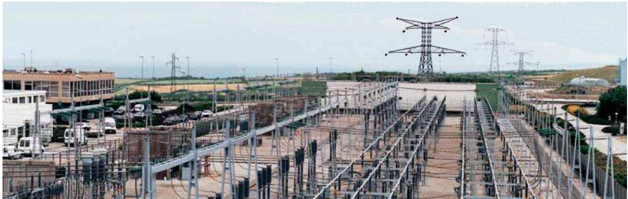
Poste principal d'alimentation électrique (AREVA La Hague)
