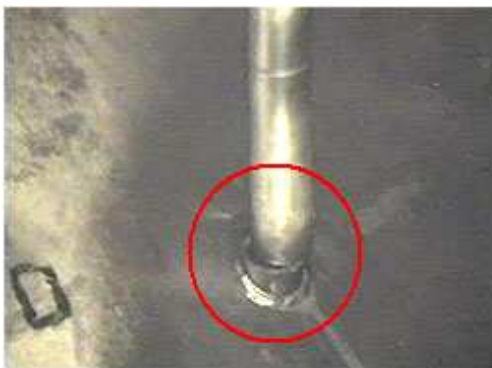
Rupture par fatigue mécanique de la tuyauterie d'alimentation de la cuve « bilan » de l'usine THORP
