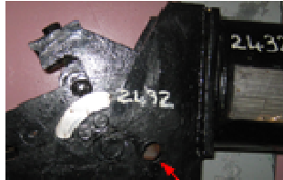
SPC conforme : absence de goupille
