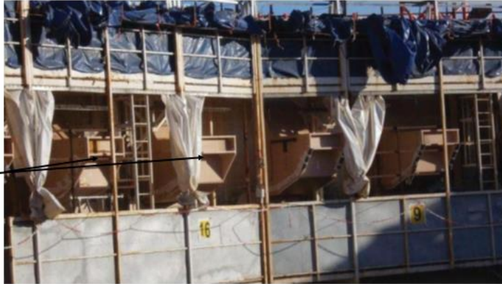
Figure 5 : Vue des consoles de supportage du pont polaire de réacteur EPR de Flamanville 3
