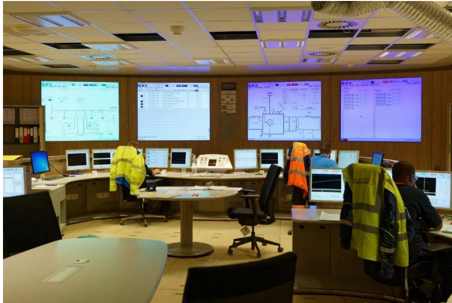
Figure 10 : Vue d'ensemble du moyen de conduite principal, entièrement numérique, à l'EPR de Flamanville.
