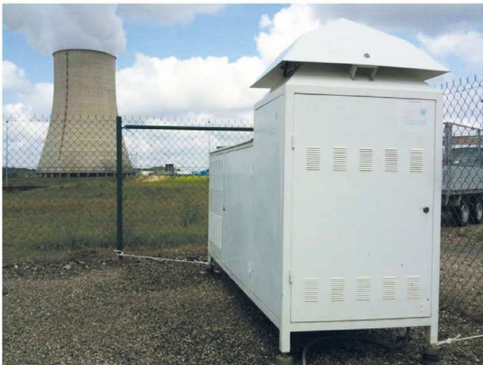
Figure 7. Photo de la station GD mobile installée au point AS1 du site nucléaire de Golfech.
