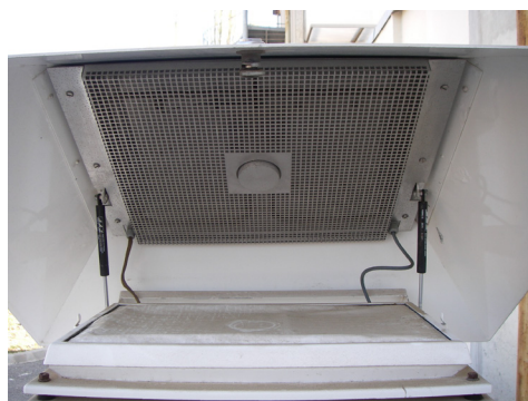
Figure 4. Filtre de la station de collecte d'aérosols à 300\text{m}^3/\text{h} .
