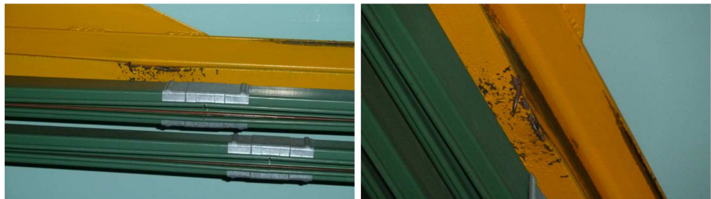
Déformations constatées sur le chemin de roulement du chariot du palan de 50 kN
